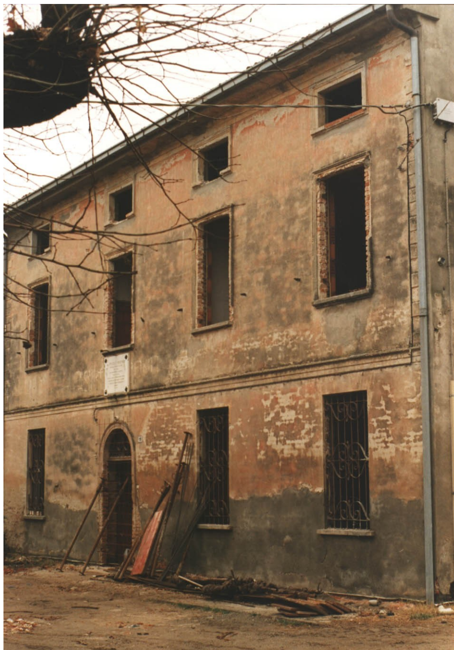
IL NUOVO ASILO IN FASE DI RISTRUTTURAZIONE e di seguito DIVERSE VEDUTE DEL PAESE
